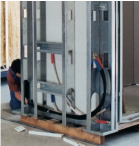
Abb. 28: Lochung von Leichtprofilen mit durchgeführten Installationen
